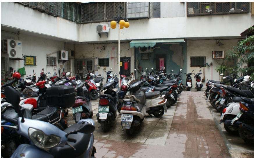
停滿機車的封閉巷子，不僅進出不易，一旦發生災害，亦會造成逃生困難。
